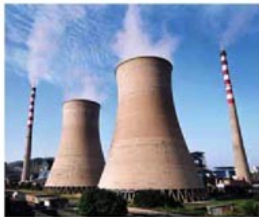
图 10.4-4 热电厂的冷凝器。烟筒似的器壁内有很多管道，来自蒸汽轮机的废气在管道内冷却。器壁的下沿与地面间留有缝隙，便于冷凝器内空气的流动，同时有冷水喷到管道上，增强冷凝效果。
