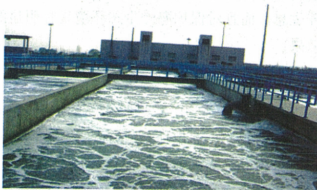
图 4-50 城市污水处理厂的好氧处理池
