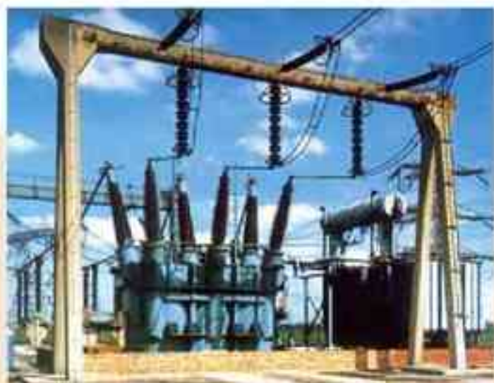
甲 变电站的大型变压器
