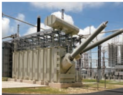
甲 变电站中的大型变压器
