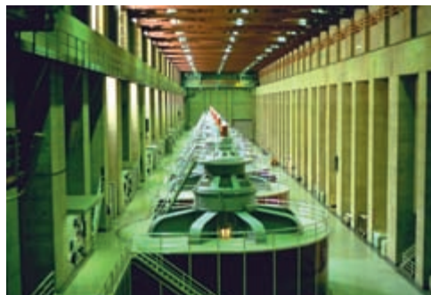
图20.5-6 现代水力发电厂中的发电机组。发电机的轴是竖直安装的，轴的下面连接着水轮机，在强大水流的冲击下旋转。
