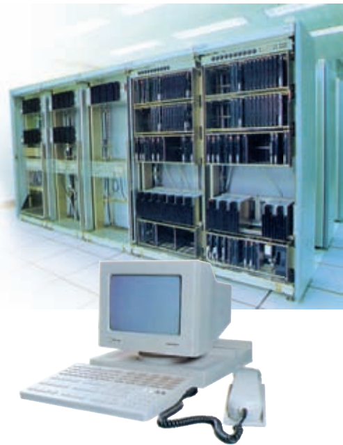
图 21.1-6 程控电话交换机和操作台
